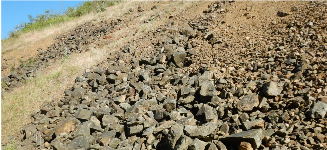
Photo 2 : zone ponctuelle d'éboulement sur une pente au sud de la butte
