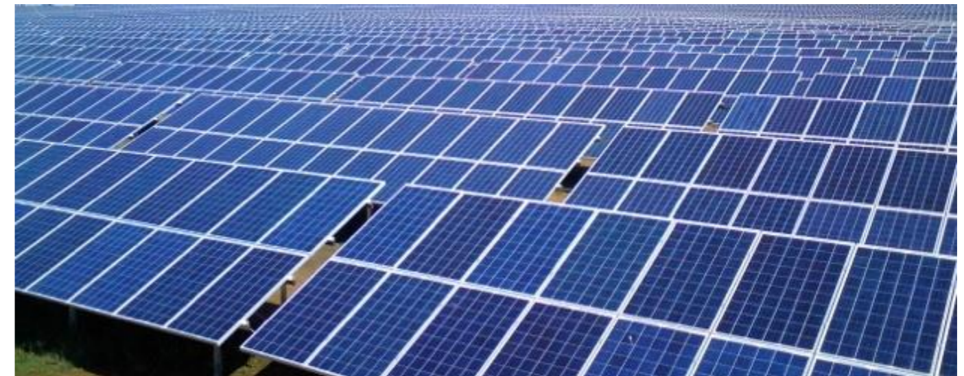
Photo 17 : exemple de tables accueillant des panneaux photovoltaïques
